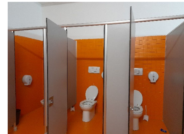
rivestimenti con piastrelle in monocottura e pannelli in melaminico laminato bagni per il pubblico - padiglione 3b
