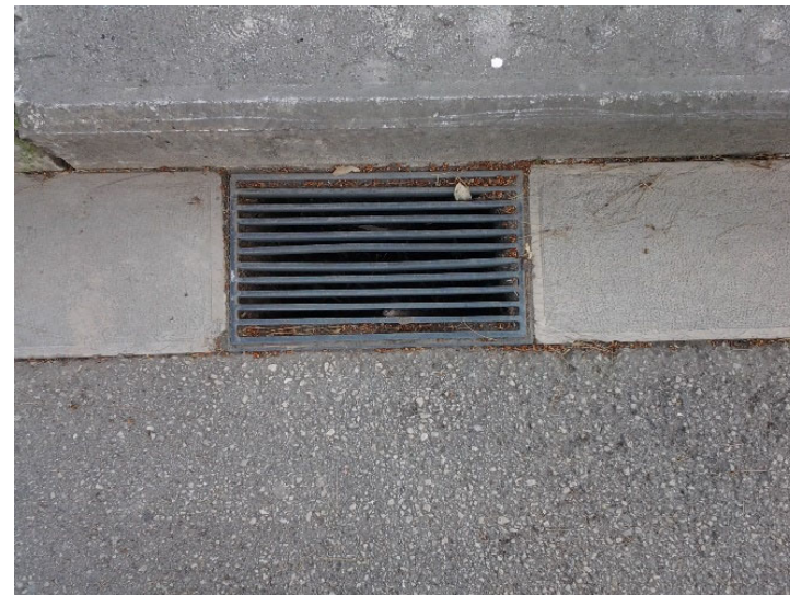
caditoia di raccolta acque in ferro viale delle ortensie
