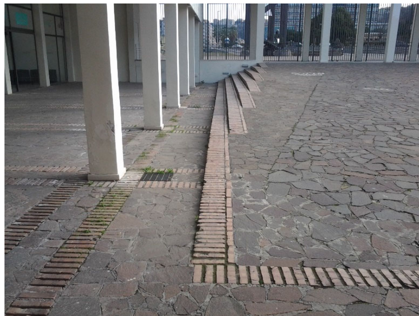
pavimentazione in bollettonato di porfido e mattoni pieni aree esterne ai padiglioni fieristici
