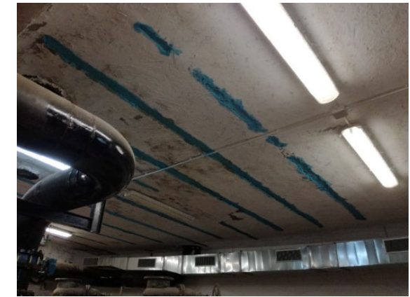
locali tecnici interrati
