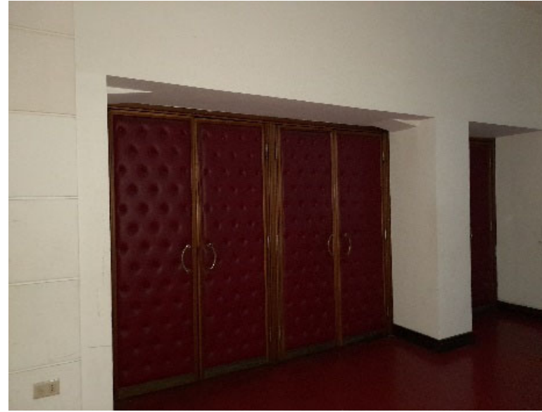
porte a ventola tra l'atrio ed il foyer del teatro
