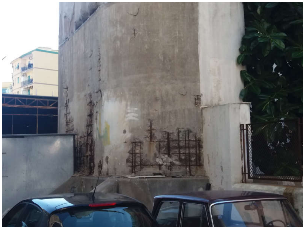
Fig.5 – Pilone 1 – Parte bassa – Lato Est
