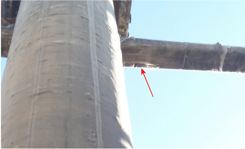
Fig.8 – Pilone 1 – Parte alta - Lato Ovest – Probabile distacco di blocco di calcestruzzo ( freccia rossa)
