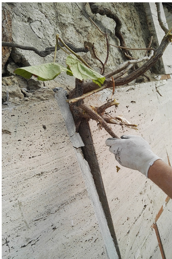
foto 4 – lastre in travertino, distaccata dal supporto murario
